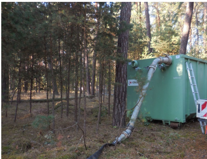
Absetzbecken vor Einleitung in den Main-Donau-Kanal
