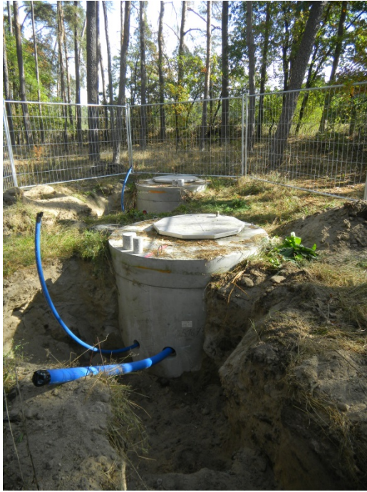
Anschlüsse an Schutzbrunnen
